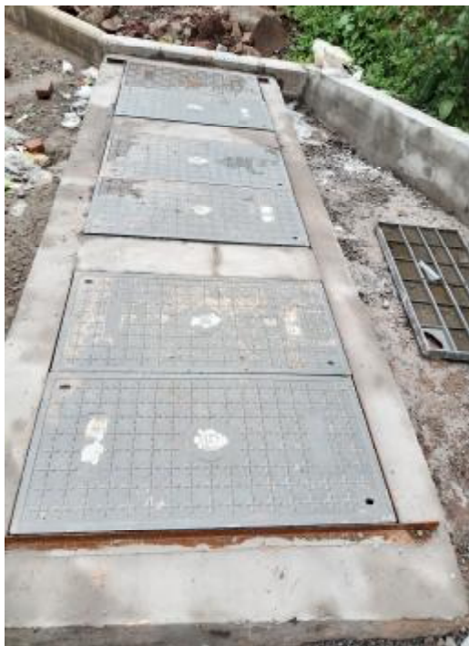
图 3.3 洗车废水隔油池
