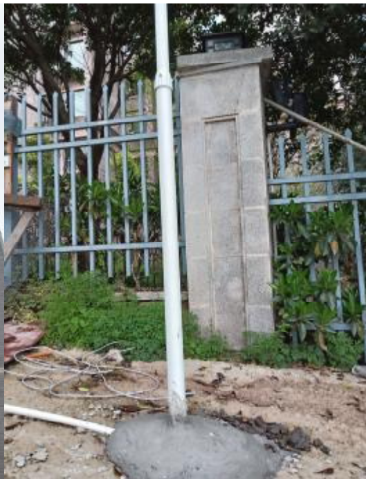
图 3.2 污水处理池臭气排放管道
